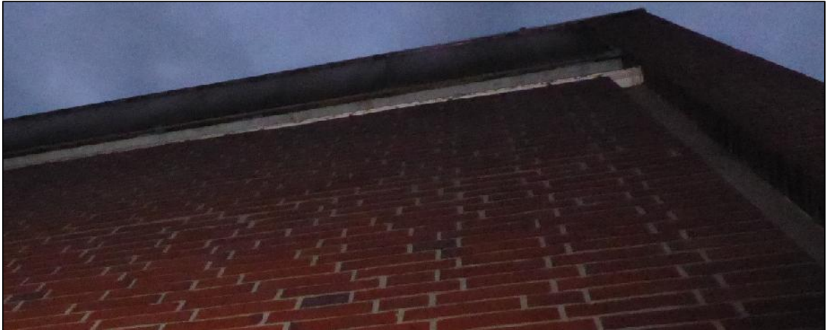
Abbildung 3: Spalte im Dachrand der Sporthalle
